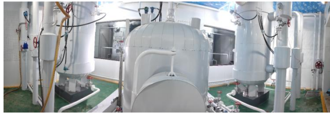
太原超长重力热管供暖系统现场照片（2022.07）
