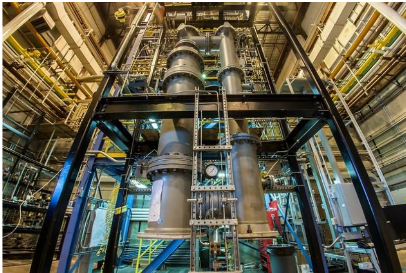
图 1 西弗吉尼亚州摩根敦实验室的 50 kW 化学链反应器
